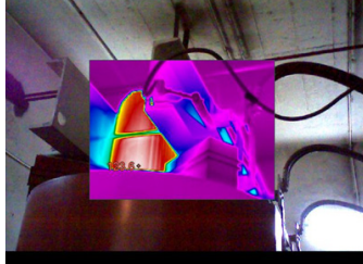
干式变压器铁芯温度检测
